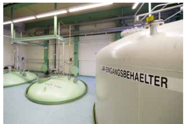
Chemieabwässer und andere nicht brennbare Flüssigkeiten werden in großen Tanks gesammelt und durch Verdampfen aufkonzentriert.
