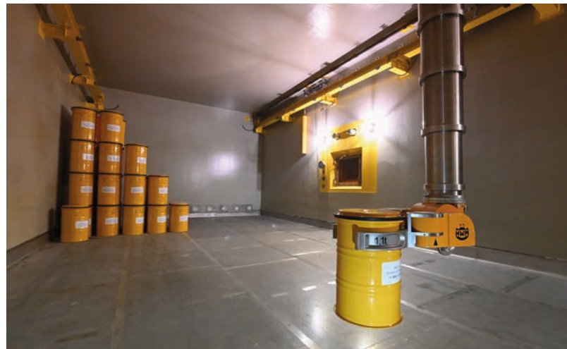
Blick in eine Lagerkammer des neuen MAW-Zwischenlagers (inaktive Testphase).
