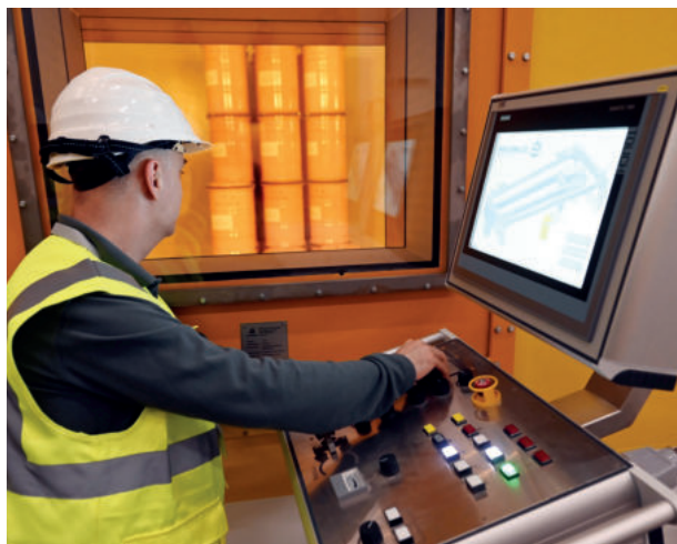
Blick ins MAW-Zwischenlager.
